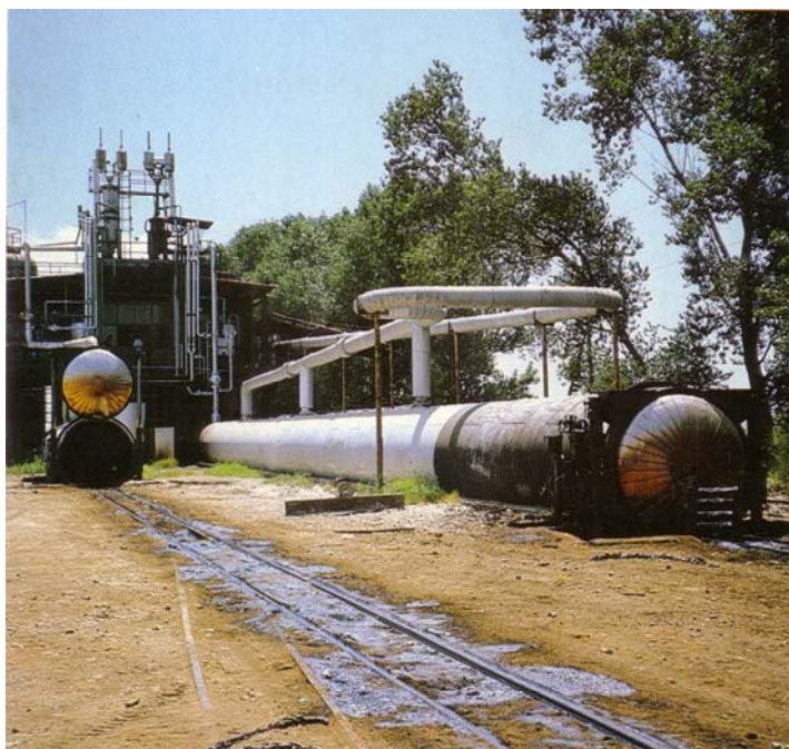
Figura 2. Planta de tratamento com autoclave de seção transversal circular, utilizada para o tratamento da madeira por processos que utilizam vácuo e pressão .
